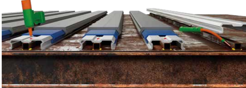
Свободные алюминиевые подпалубные профили, заклепанные на стальном коробчатом профиле, приваренном к стальной пластине.
